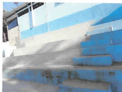
Foto 6: Vista del graderio en mal estado que necesita reparación.
