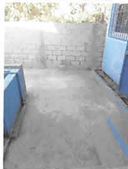
Foto 2: vista de la torta de cemento del frente de la cocina que necesita reparación.
