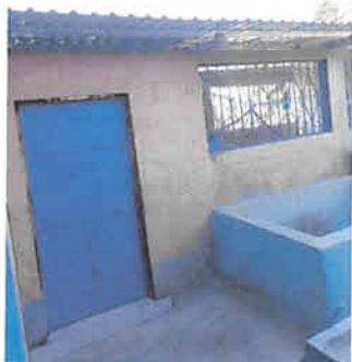
Foto 1: vista del frente de la cocina que necesita reparación.
