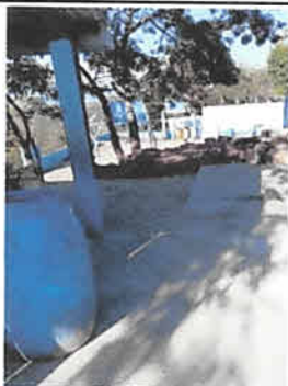
Foto 3: Vista de la torta del frente de los sanitarios que necesita reparación.
